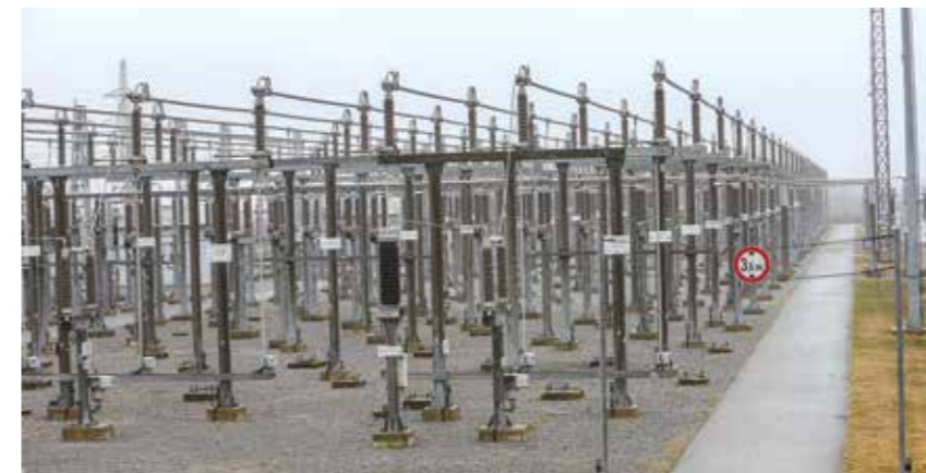
↑ Obnova u ratu uništene TS 400/110 kV Ernestinovo kod Osijeka bio je jedan od preduvjeta za rekonstrukciju
