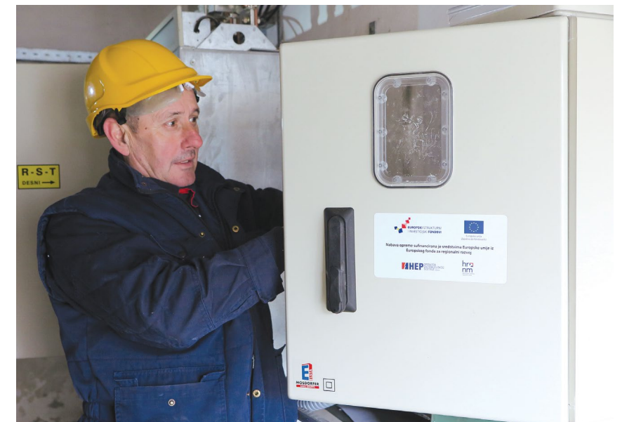
↑ Ugradnja sumarnih mjerenja tijekom Pilot-projekta uvođenja naprednih mreža
