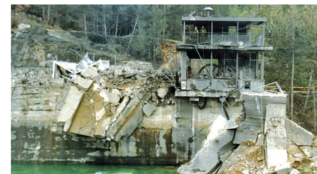
↑ HE Peruća u Domovinskom ratu: eksploziv je najviše oštetio prelivnu građevinu i injekcijsku galeriju, na kruni brane pojavili su se krateri te je voda poplavila rasklopno postrojenje i strojarnicu
