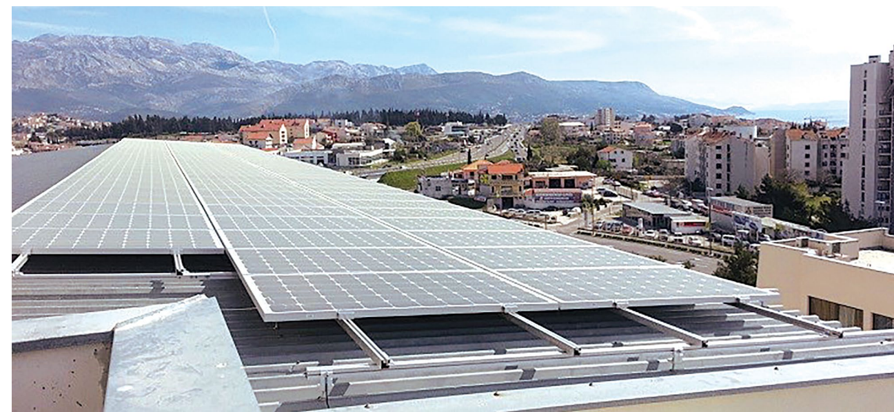
↑ Sunčana elektrana na zgradi u Splitu
