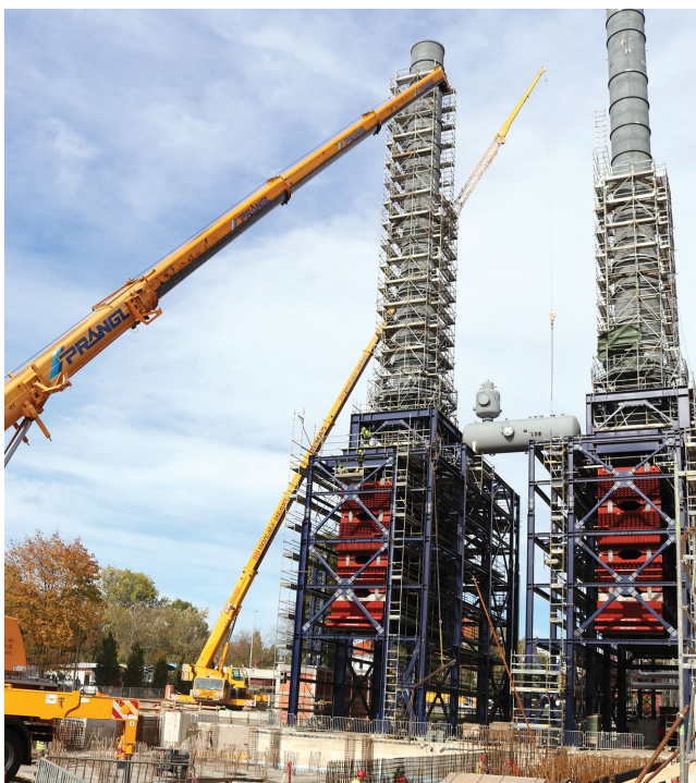
↑ Kotlovi i dimnjaci u kotlovskom postrojenju budućeg Bloka L
