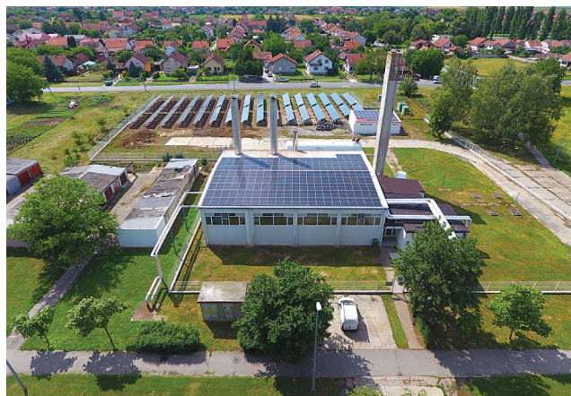
↑ Kotlovnica u Borovom naselju
