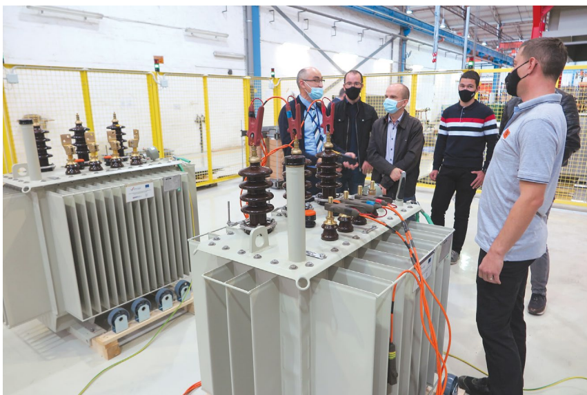
↑ Završna ispitivanja u Končaru prije prve isporuke energetski učinkovitih transformatora.
