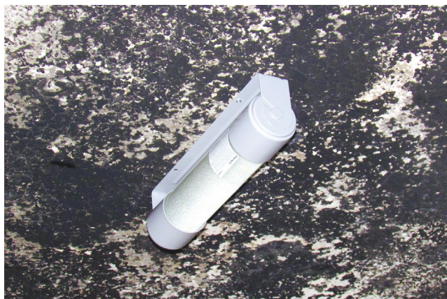
↑ Ispitano je djelovanje samoaktivirajuće ampule za gašenje požara, koja se koristi u transformatorskim stanicama 10(20)/0,4 kV
