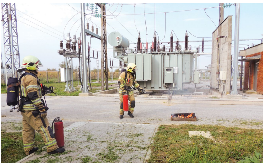
↑ Požar elektroenergetskog transformatora izazvan je simuliranjem dima i vatre na otvorenom prostoru
