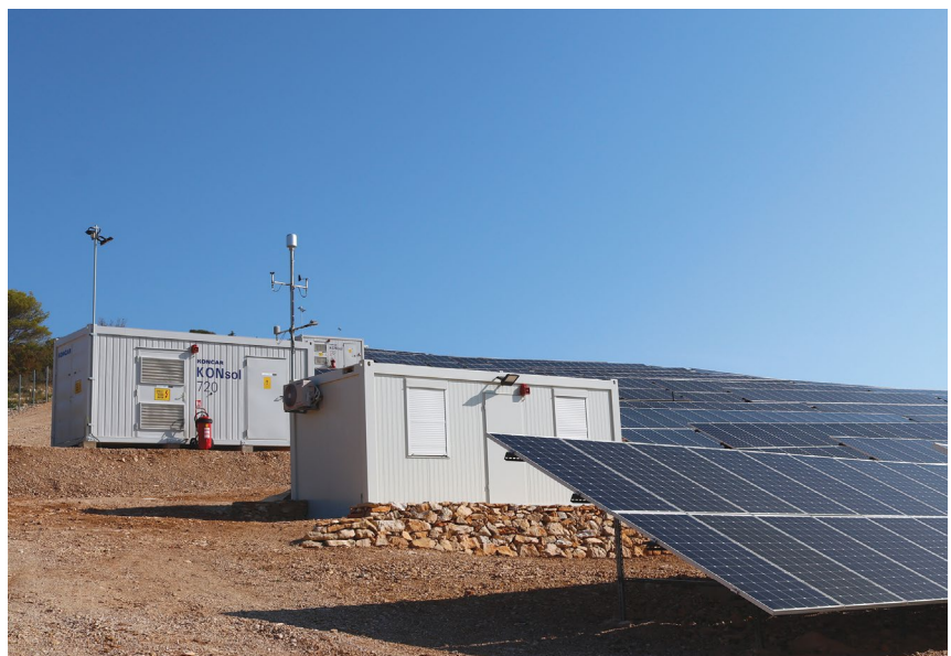
↑ Končarevi KonSol pretvarači osiguravaju izravno spajanje elektrane na distribucijsku mrežu
