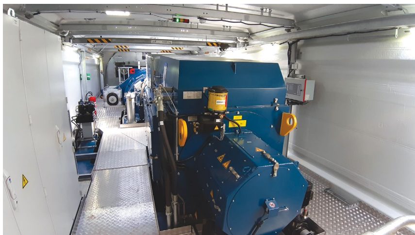
↑ Generator vjetroagregata nalazi se u unutrašnjosti gondole
