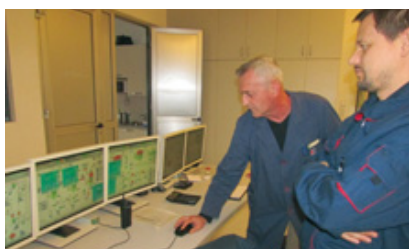
Pred monitorima upravljačkog sustava Bloka 45 MW
