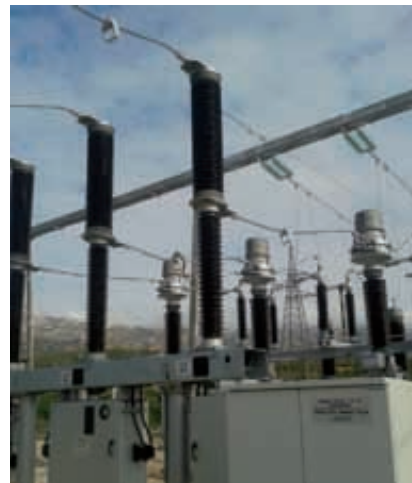
TS 110/35 kV Obrovac spremna za prihvatanje električne energije proizvedene u vjetroelektrani Zelengrad
