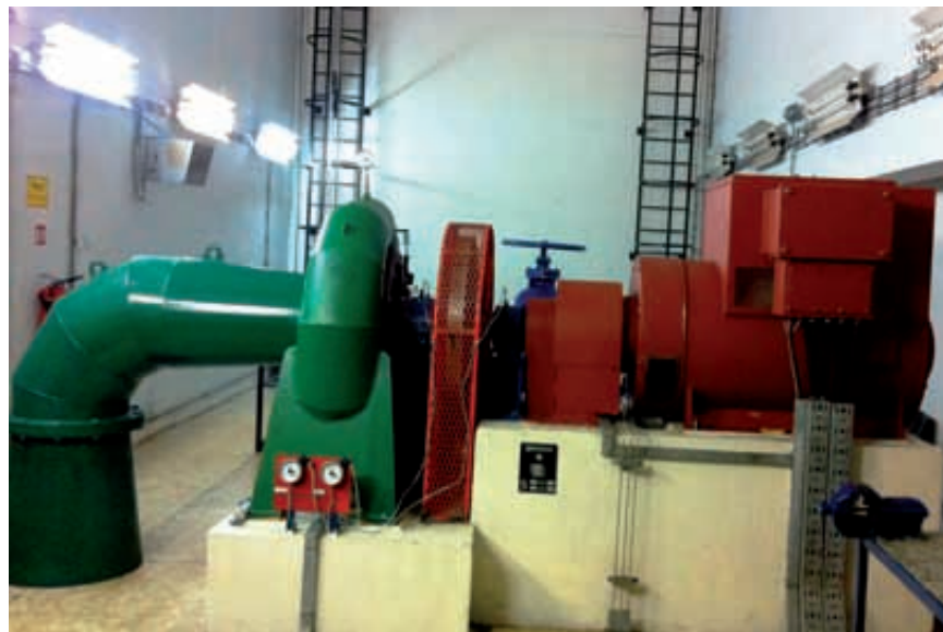
Agregat biološkog minimuma na lokaciji MHE Krčić, izgrađen 1988. kao prva faza budućeg cjelovitog postrojenja
