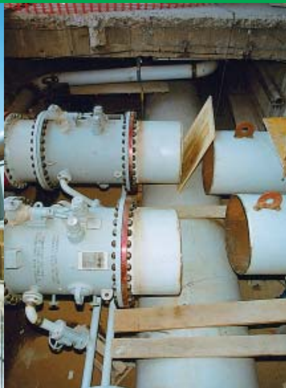
Cjevovodi rashladne savske vode
