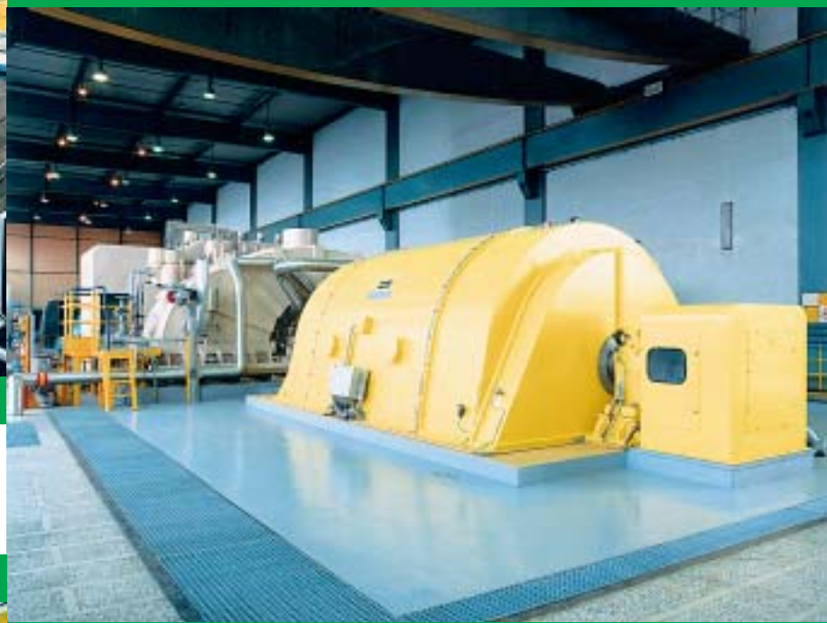
Turbina i generator
