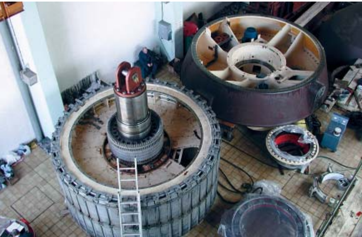
Stator i rotor na montažnom prostoru
