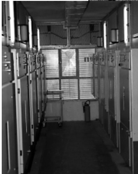
Rekonstruirana TS 35/10 kV Bol
