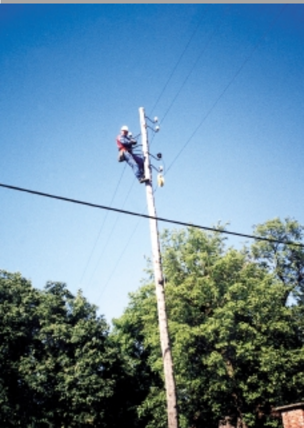
Elektromonter PU Dubrava Dejan Dlesk na prijelazu DV 10 kV Novaki preko glavne prometnice
