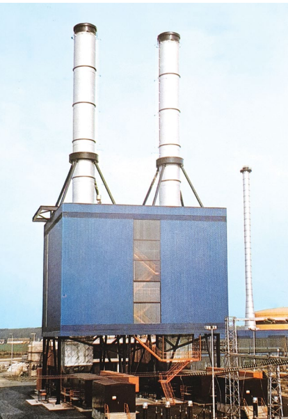
↑ Plinsko turbinski agregat na lokaciji TE-TO Osijek
