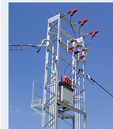
↑ Stupna transformatorska stanica s ugrađenim izolacijskim materijalom
