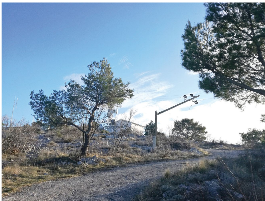
↑ Jedno od oštećenja na području Elektre Šibenik
