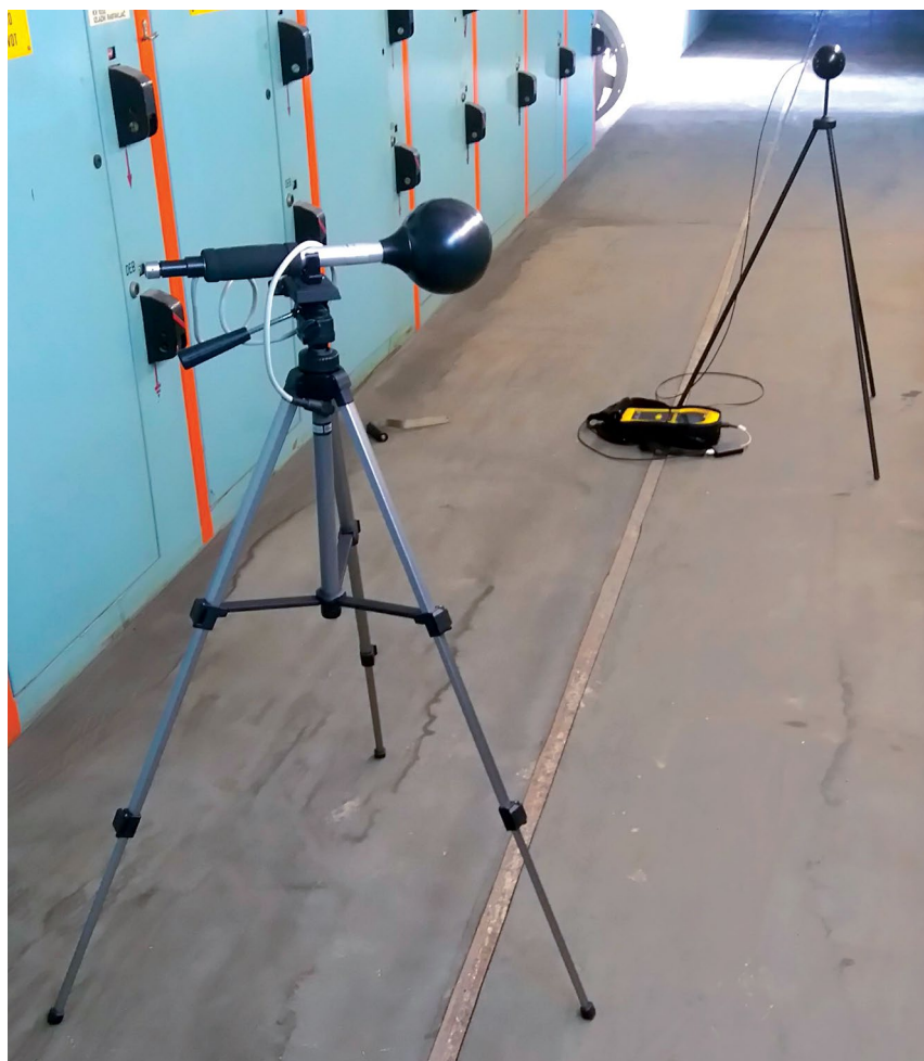
↑ Instrument za mjerenje električnog i magnetskog polja u transformatorskoj stanici VN/SN (u unutarnjem dijelu postrojenja)
