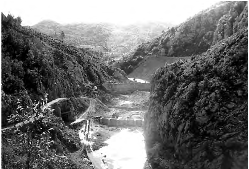
↑ Glavni radovi na izgradnji HE Sklope počeli su 1968. te su se odvijali bez zastoja, izuzev zimskih mjeseci, zahvaljujući dobrim pripremama i kvalitetno izrađenom glavnom projektu
