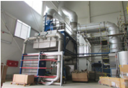
Kondenzator dimnih plinova u GPO
