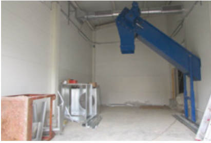
Izlaz transportera pepela ispod kojeg će doći kontejner za pepeo
