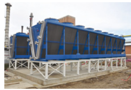
Montirani hladnjak (dry cooler) čeka spajanje na kondenzator
