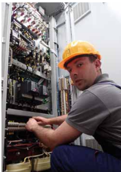
Provjera na sustavu uzbude agregata 1
