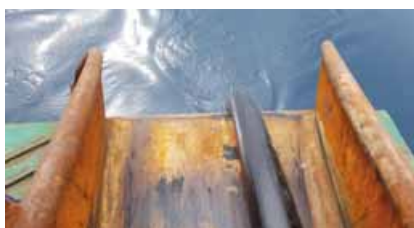
Uz pomoć mehanizacije, kabel je besprijekorno postavljan na morsko dno, putujući s broda...
