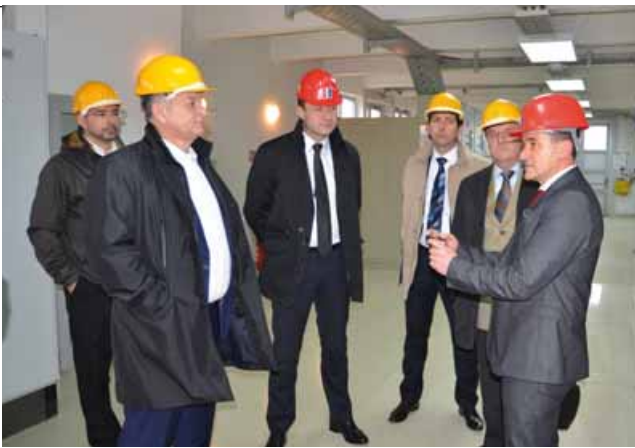
Predsjednik Uprave HEP-a Perica Jukić, domaćini i uzvanici u obilasku Trafostanice 35/10(20) kV Bjelovar III
