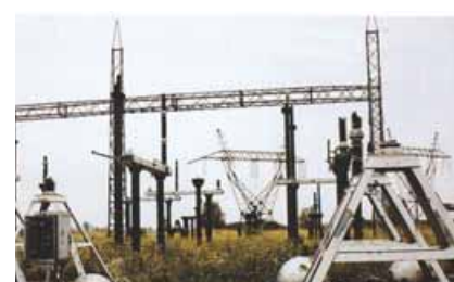
Ostaci prekidača 400 kV
