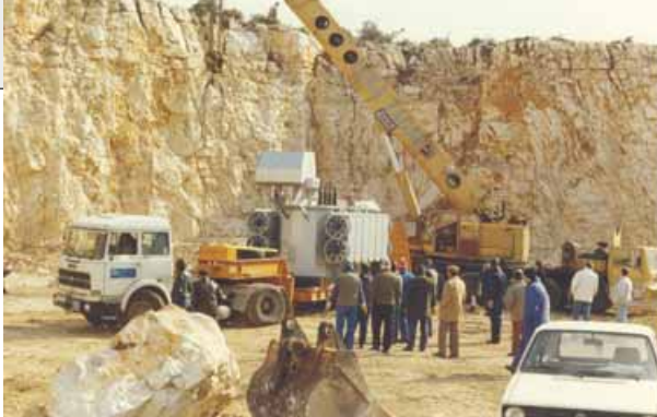
U samo osam dana izgrađena je provizorna i skrivena transformatorska stanica 110/10 kV Kava
