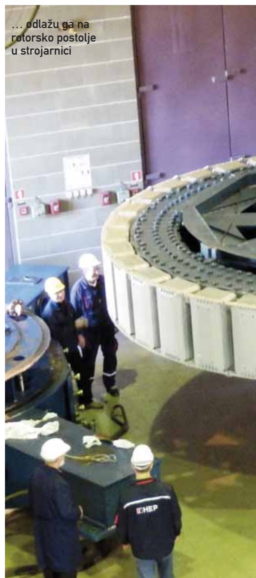
Ekipe Končar GIM-a i posada HE Đale vade rotor turbine A i...
