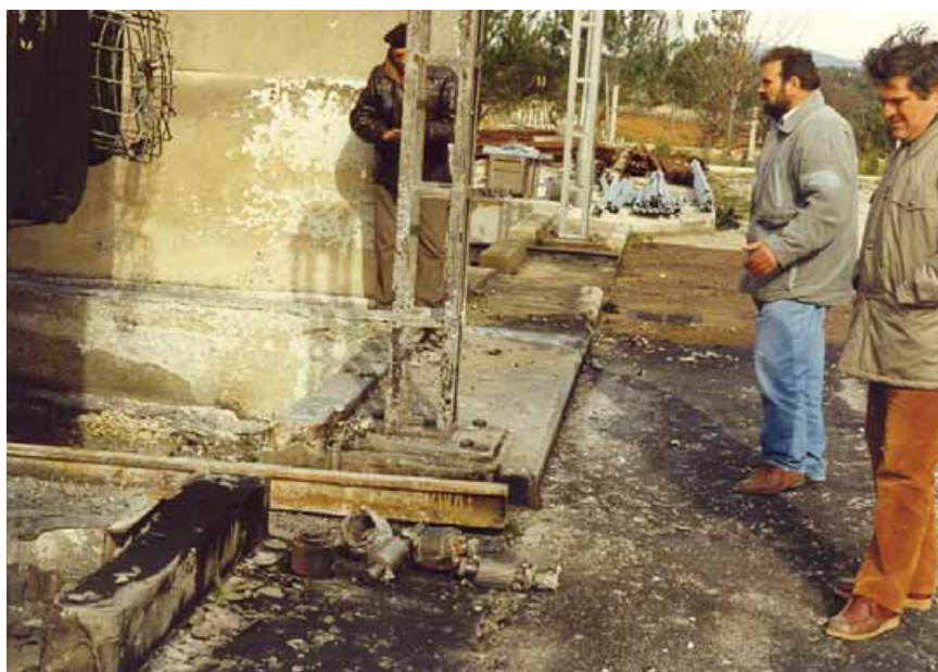
Teško oštećena TS 110/35 kV Biograd
