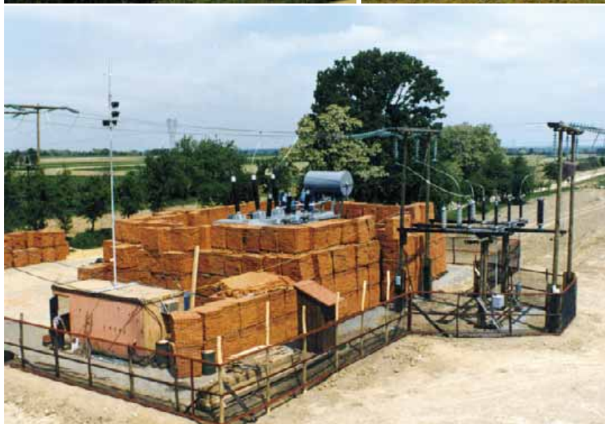
Privremena TS 220/110 kV "1505/2" izgrađena na livadi jugoistočno od Našica i skrivena zaštitnim zidom od blokova opeka, također je bila spas za energetski krvotok Slavonije i Baranje
