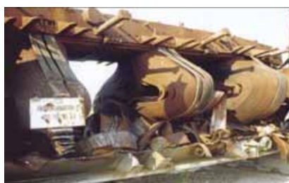
Ovo je bio transformator 400/110 kV
