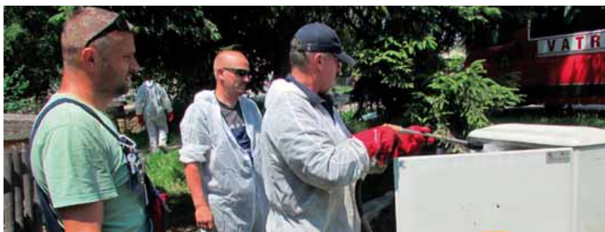
Igor Vrkić i Kristijan Turk čekaju da vatrogasac od blata opere i dezinficira samostojeći razvodni ormar, jer pravilo je bez iznimaka: elektraši mogu raditi na elektroenergetskim postrojenjima i objektima tek nakon što ih vatrogasci operu
