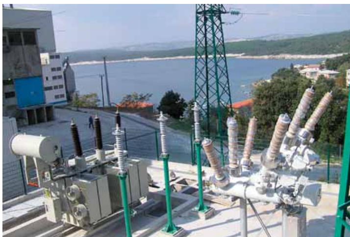
Jednostavna TS 110/6 kV, prva takve vrste u Hrvatskoj (izgrađena za potrebe Tvornice cementa Koromačno)
