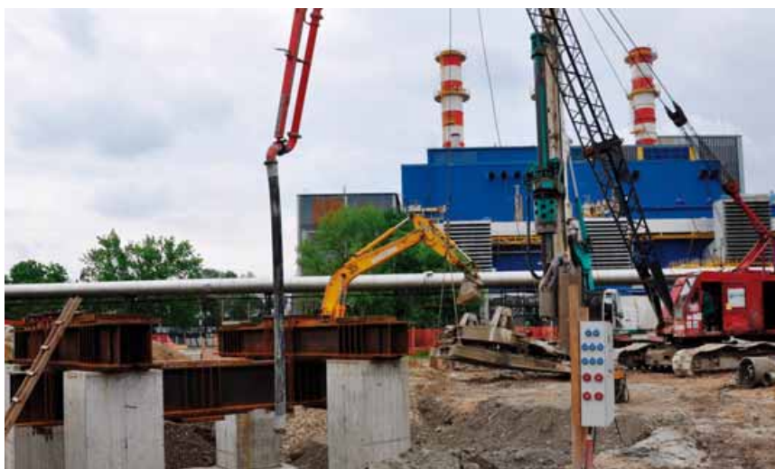
Ovdje niče nova jedinica, koja će unaprijediti način upravljanja cijelim velikim sustavom TE-TO Zagreb, a probni pogon akumulatora topline planira se u ogrjevnoj sezoni 2015./2016. godina
