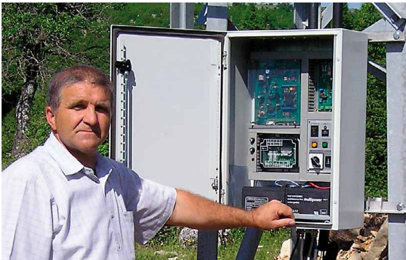
Željko Mišković pokraj ormara u kojemu je ugrađen njegov sklopni uređaj - rastavljač
