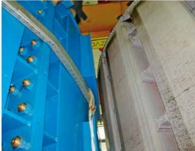
U ovom bliskom susretu mogle su se izmjenjivati tek vizualne nježnosti između agregata D i statora novog generatora A
