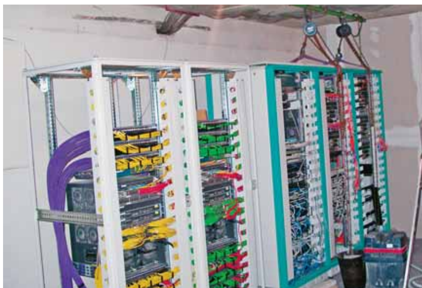
Mrežne ormare nije se smjelo baš previše micati, pa su pri postavljanju dvostrukog poda dignuti u zrak
