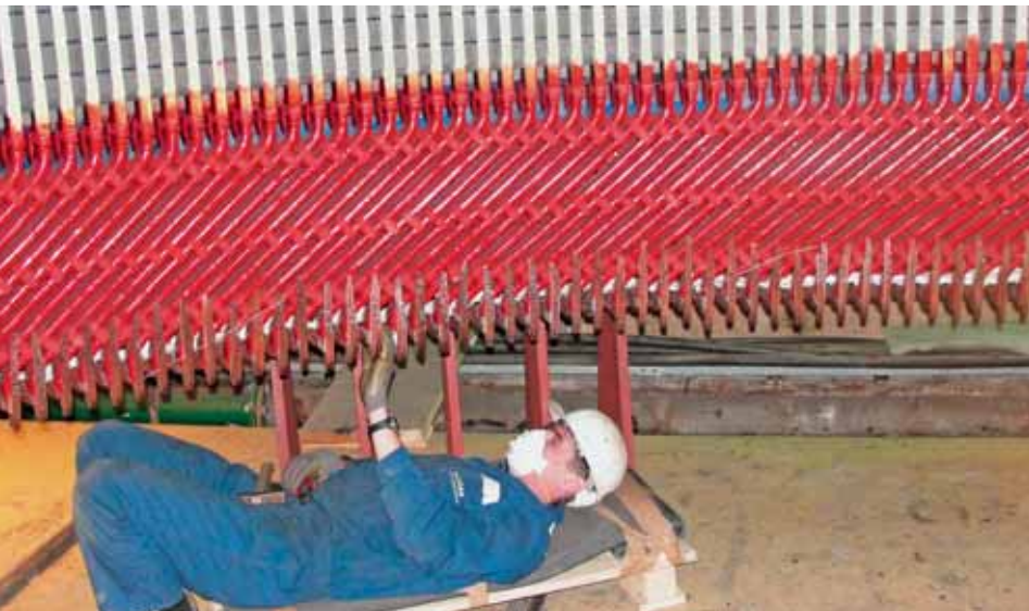
Za novi generator A, u završnoj fazi je namot statora
