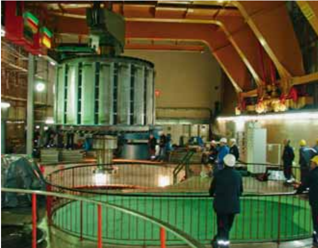
Posada elektrane sama je obavila demontažu pokvarenog i potom montažu saniranog generatora A
