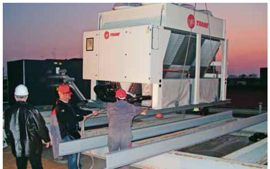
Dva rashladnika Trane , jedna su od komponenti novog rashladnog sustava visoke učinkovitosti, a njihovo dizanje na krov zgrade Nacionalnog dispečerskog centra bilo je osobito zahtjevno
