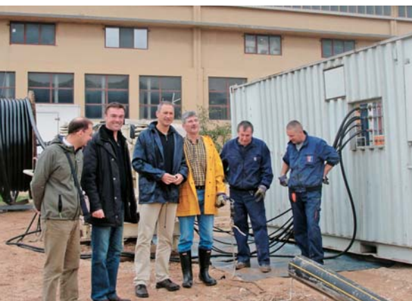
Oni su odgovorni za uspješno obavljene posao: Domagoj Milun - rukovoditelj Odjela za građenje (drugi s lijeva), Arsen Batarelo - glavni inženjer (u sredini) i Mate Mijić - voditelj polaganja podmorskog kabla
