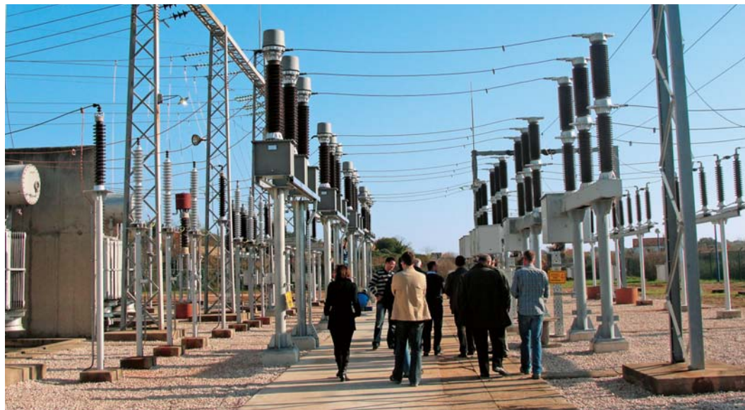
Rukovodstvo PrP-a Split i njihovi gosti u obilasku obnovljenog postrojenja trafostanice Stari Grad
