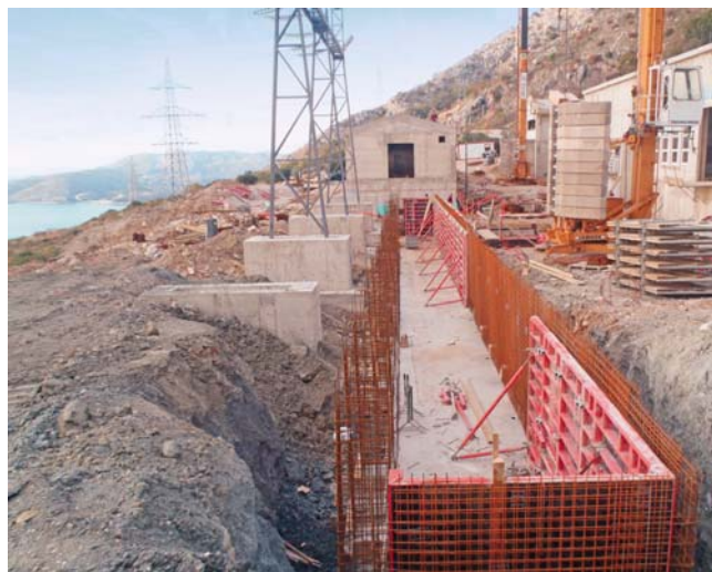
Završeni su armirano-betonski radovi na zgradama postrojenja 35 kV, 20(10) kV i 220/110 kV i zgradi upravljanja, a u tijeku su zanatski radovi
