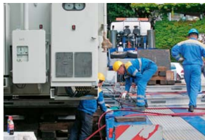
...s privremenog skladišta transformator će otputovati u rasklopište...
