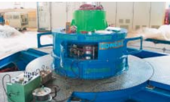
Strojarnica HE Peruća u vrijeme pregleda agregata
