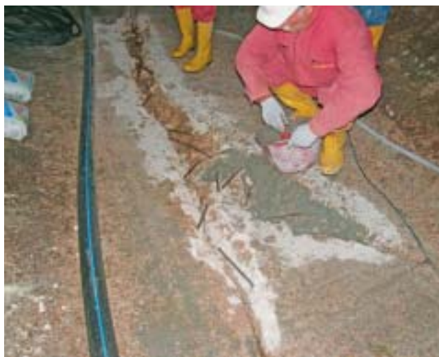
Sidra u pukotini u dnu dovodnog tunela
