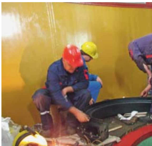
... na turbini agregata B
