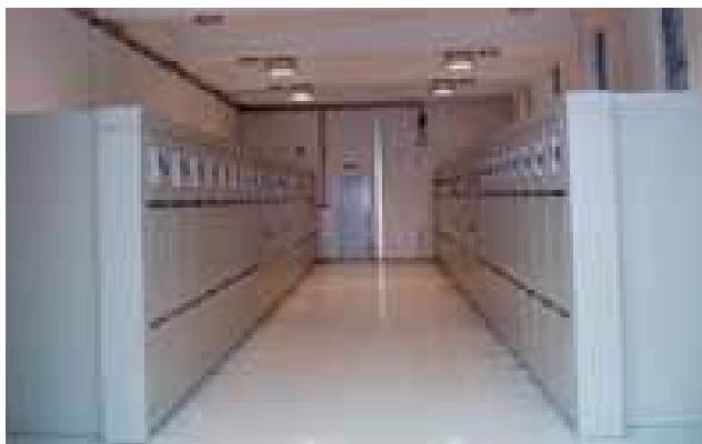
Srednjonaponsko postrojenje u TS 110/10(20)kV Turnić
