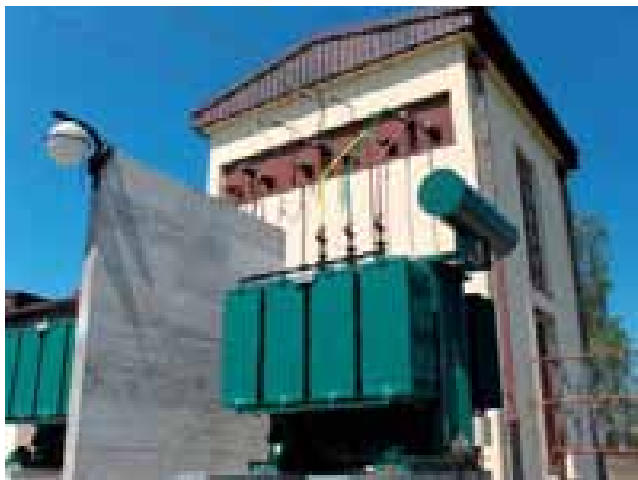
Transformatori u TS 35/10(20)kV Križ
