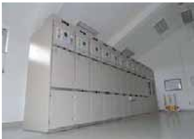
Srednjonaponsko postrojenje u TS 110/10(20)kV Đakovo
