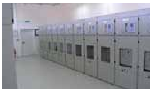
Srednjonaponsko postrojenja u TS 35/10(20)kV Sali
