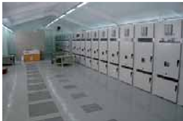
Zgrada TS (110)30/10(20)kV Podi i srednjonaponsko postrojenje
