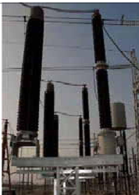
Slika 2: Naponski transformatori snimljeni u postrojenju
