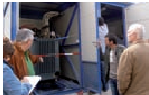
Povjerenstvo splitske Elektrodalmacije, koja je i izdavatelj elektroenergetske suglasnosti i predstavnici izvođača radova zajedno su pregledali trafostanice
