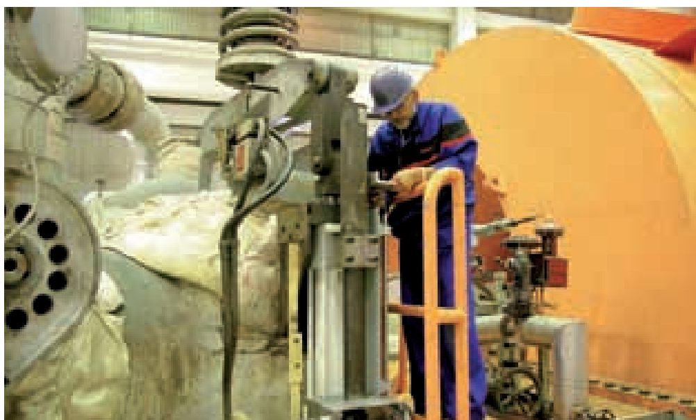
Tehničar instrumentacijskog održavanja radi na sustavu regulacije hoda/položaja ventila za regulaciju dotoka pare na visokotlačnu turbinu
