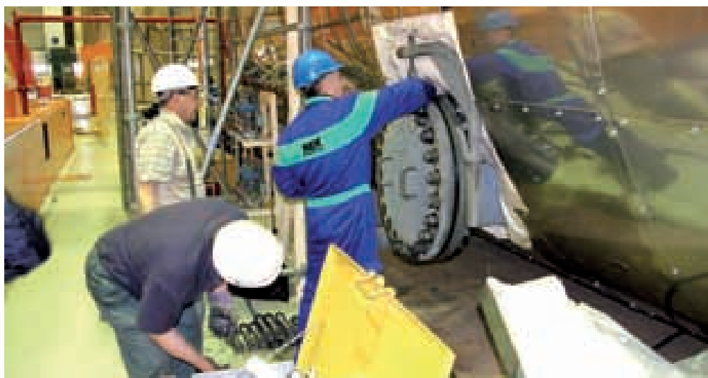
Postupak zatvaranja inspeksijskog otvora nakon pregleda/ispitivanja unutrašnjih komponenti MSR-a (Moisture Separator Reheater - odvajać vlage iz pare i dogrijač pare)
