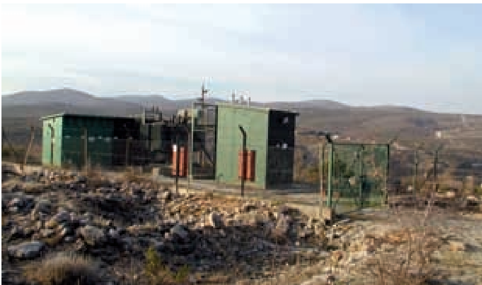
Stara kontejnerska TS 35/10 kV
