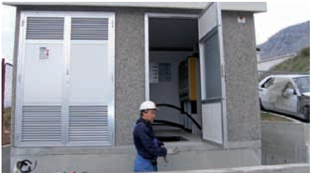
M. Kučić obavlja završne poslove u TS - uvlačenje i spajanja položenog kabela.
