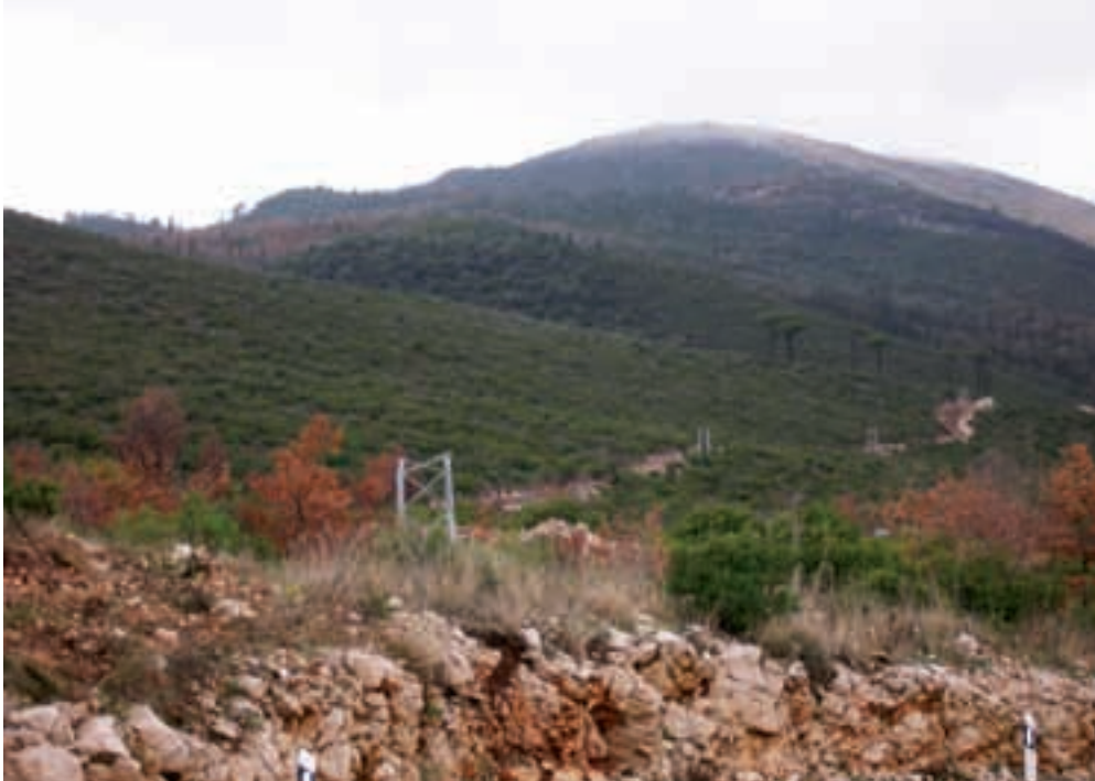
Trasa DV 35 kV Pločice – Prevlaka i čelično-rešetkasti stupovi koji su započeli nicati
