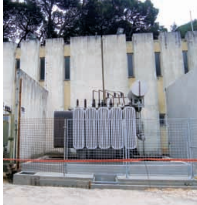
U TS Lapad jedan novi transformator od 16 MVA već je postavljen, a ubrzo će biti i drugi
