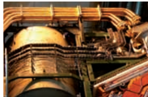
U drugoj fazi su vodom hladene, svinute sabirnice duljine devet metara, montirane kada je postavljen glavni magnet
