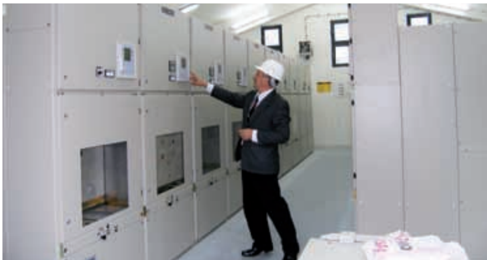
Rukovoditelj Službe za razvoj i investicije Jero Krile, uz novo 10 kV postrojenje u TS Komolac
