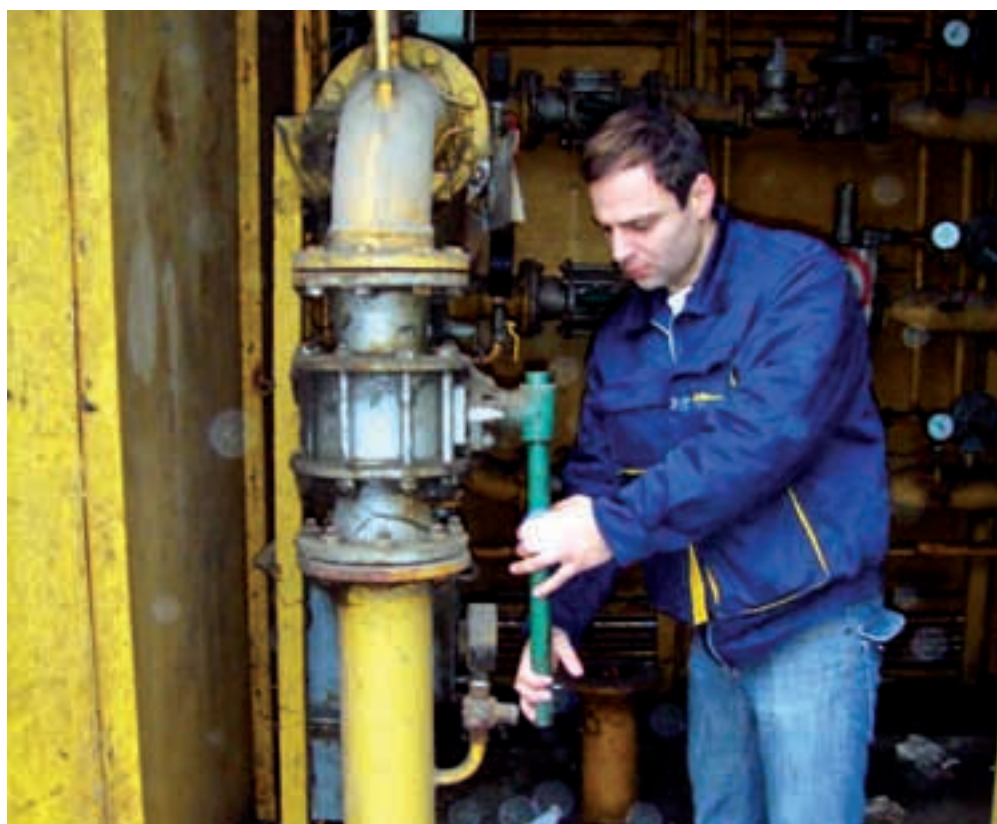
Zatvaranje ventila na mjerno-redukcijskoj stanici kod osječke Saponije
