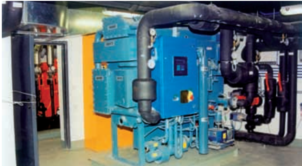
U poslovnoj zgradi energetskog instituta "Hrvoje Požar" koncipirano novo energetska rješenje - GUK sustav za grijanje, ventilaciju i hlađenje, a sastoji se od toplinske podstanice, dizalice topline s bankom leda te trigeneracijskog sustava
