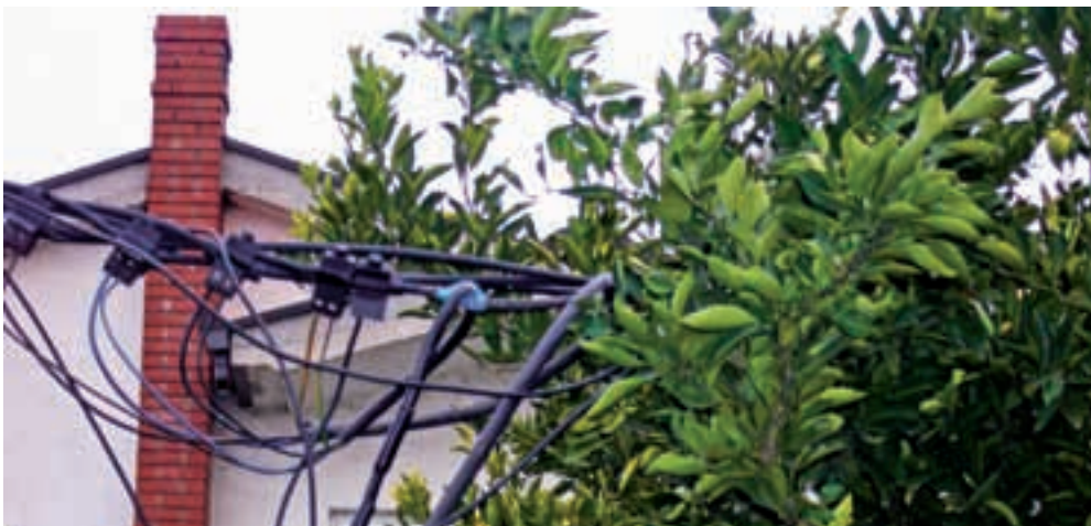
Inače mali broj kvarova na području Pogona Metković najčešće je posljedica požara ili građevinskih radova privatnih ulagača, o čemu svjedoči i ovaj kabel ostavljen među narančinim granama, nakon što ga je ošteto rovokopač
