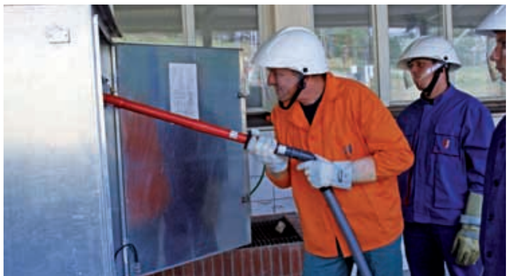
Čišćenje samostojećeg razvodnog ormarića pod naponom
