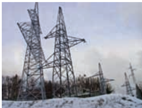
Novoizgrađeni visokonaponski poligon u HEP NOC-u
