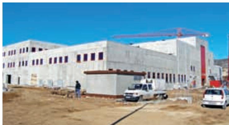
Nova zgrada tiskare Slobodne Dalmacije i trafostanica u njenom krugu
