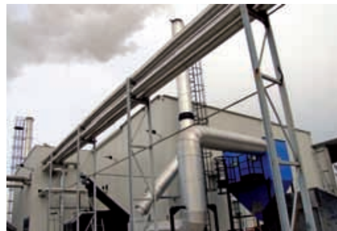
Nova kotlovnica u Belišću, u kojoj se drveni ostatak pretvara u toplinsku energiju za sušenje građe, kao i za grijanje proizvodnih hala, upravnih zgrada i mehaničke prerade drva
