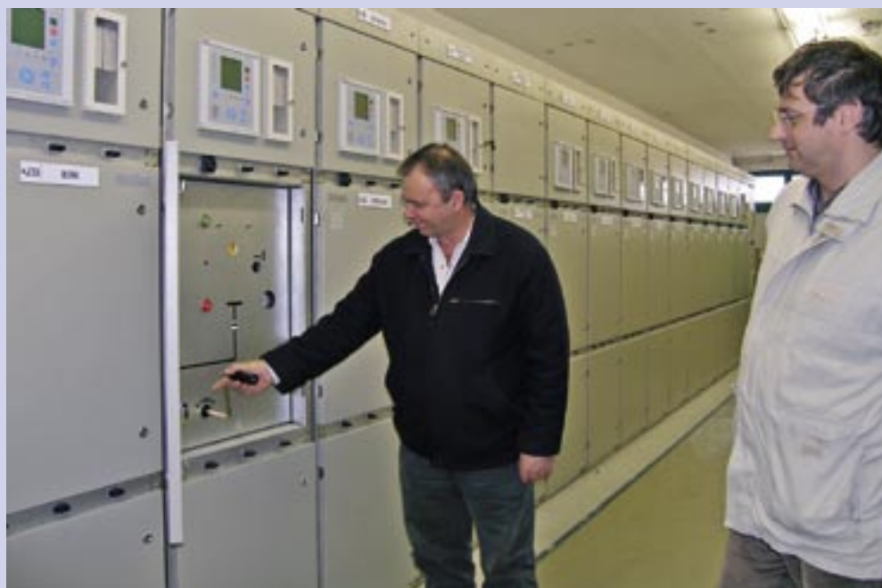
M. Gjergja i H. Dragičević uz novo 10(20) kV postrojenje u TS Zadar Centar
