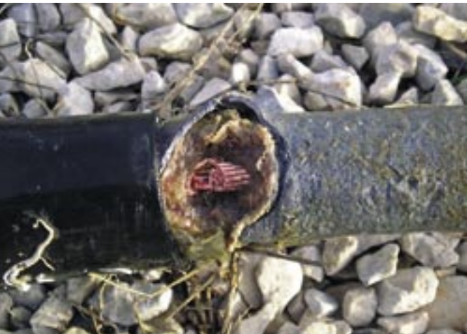
Proboj podmorskog kabela između kabelačke kućice Pisak (Seline) i TS 10/0,4 kV Vinjerac
