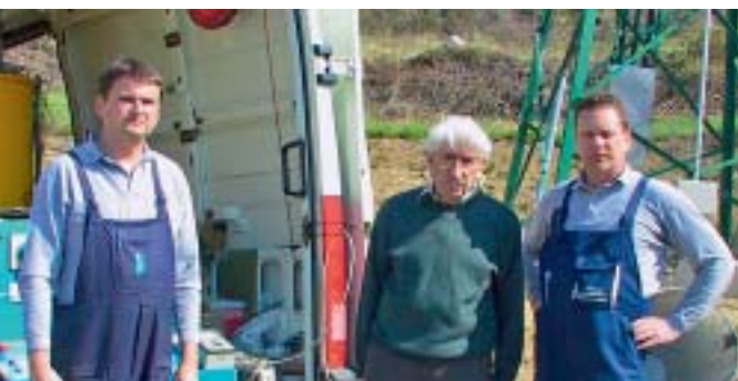
Josip Kučak i elektrotehničari Damir Sever i Srećko Jureić iz Instituta za elektroprivredu i energetiku uz pomoć prijevozne visokonaponske stanice provjerili su kvalitetu kabela, kablskih veza i izolacija te kablskih glava i spojnice na priključnom vodu 110 kV za TS 110/(10)20 kV Sušak
