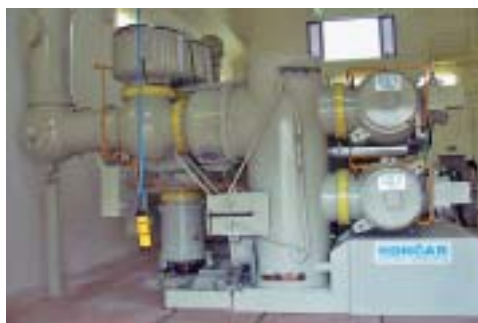
Novo suvremeno postrojenje Transformatorske stanice susretni je objekt HEP Operatora prijenosnog sustava i HEP Distribucije
