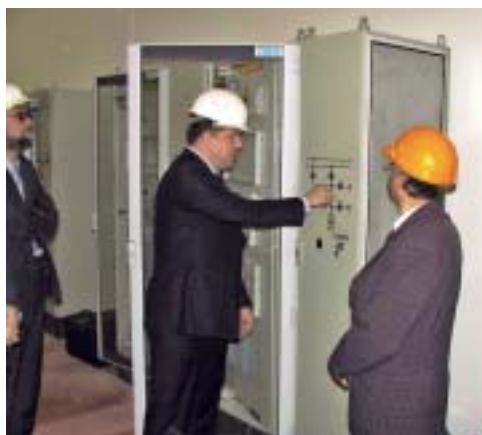
Član Uprave HEP-a za prijenos, mr. sc. Ivica Toljan pustio je u rad TS 110/10(20) kV Sušak
