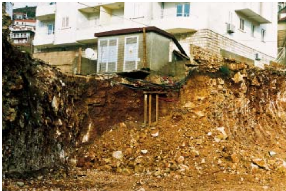
Kopanjem terena radi izgradnje kuće u Gružu ugrožena je TS 10/0,4 kV
