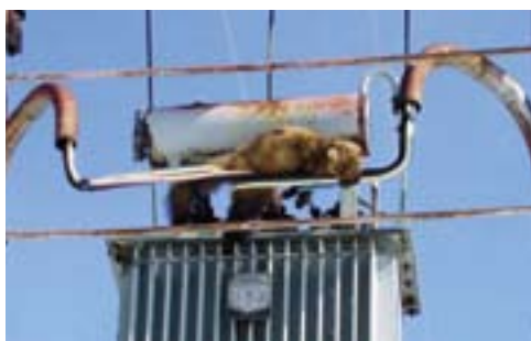
Ugradnjom sustava za poboljšanje izolacije spriječiti će se stradavanje malih životinja poput ove nesretne kune
