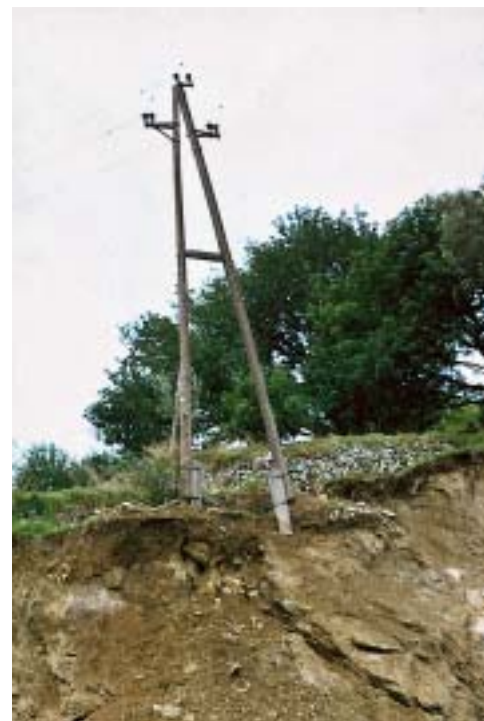
Graditelji kuće potkopali su A stup, koji se kasnije srušio
