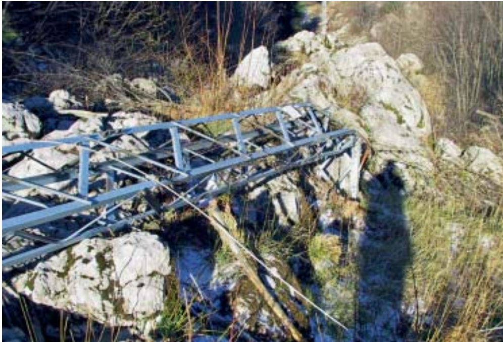
Metalni stupovi na crikveničkom području koje je bura prizemljila
