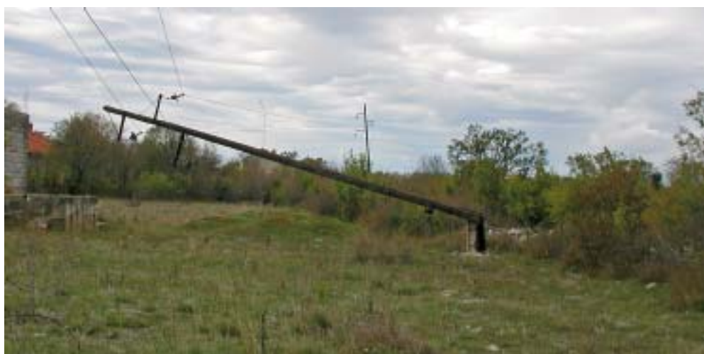
Žice drže slomljeni stup
