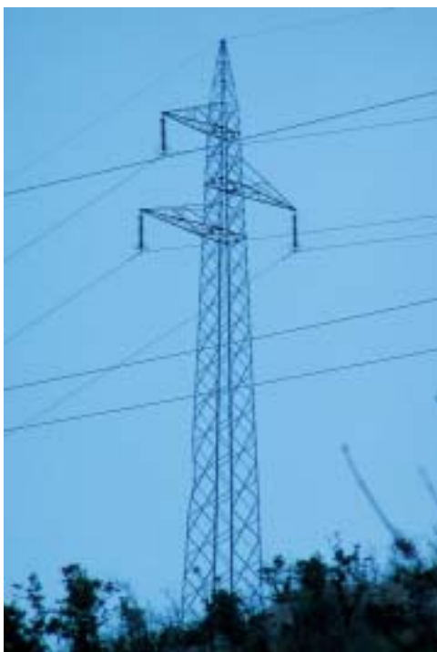
DV 220 kV Zakučac – Konjsko (stup 9 kod mjesta Naklice povrh Omiša)
