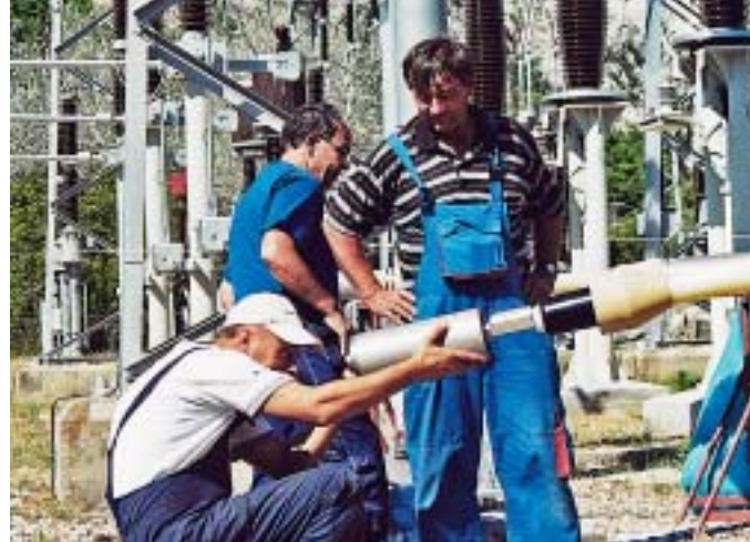
Radnici SIU izradili su tri vanjske i tri unutrašnje kableske glave 220 kv, a Simeon Popov iz ABB-a nadgleda rad
