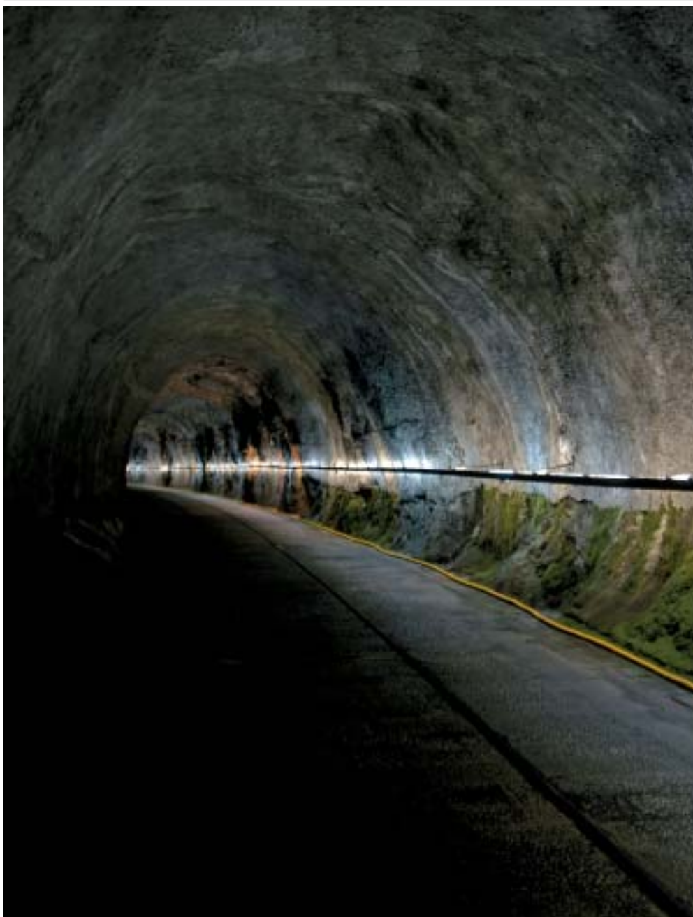
Prepoznatljivi tunel koji nas je odveo do strojarnice HE Zakućac prelijeva se u bojama
