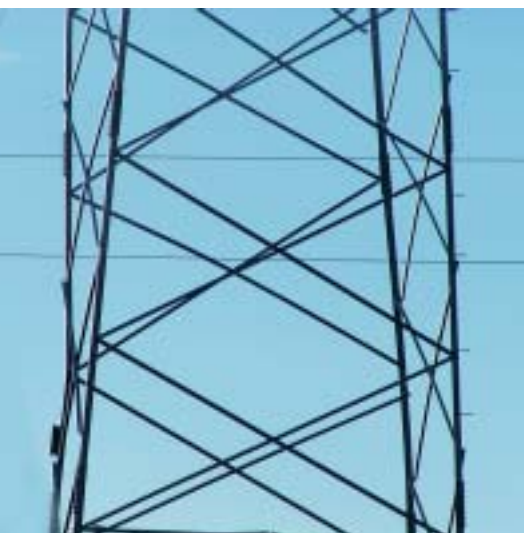
Pod udarima vjetra od 130 km na sat savijala se i čelično-željezna konstrukcija dalekovodnih stupova
