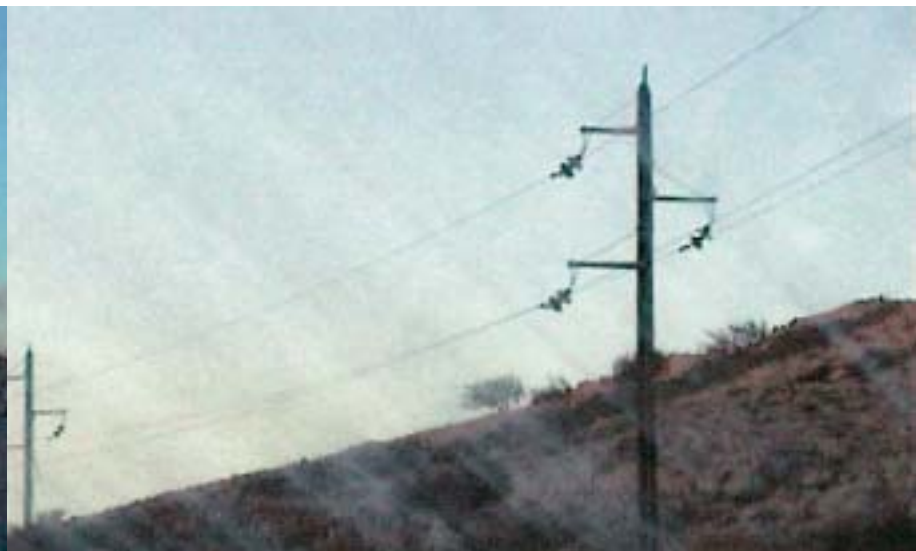
Jedan od paških vodova pod naletima orkanske bure 7. prosinca 2003.: izolatorski lanci teže vodoravnoj razini (posolice na izolatorima slična onoj na staklu kroz koji je snimak napravljen)
