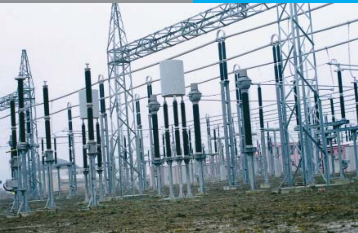
Prigušnice u RP 400 kV za VF vezu sa TS Ernestinovo
