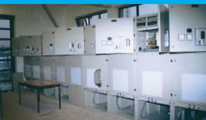
Sklopni blokovi u RP 10(20) kV
