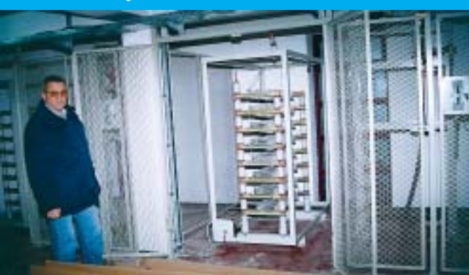
Juraj Brčić, glavni nadzorni inženjer, u prizemlju zgrade RP 10(20) kV, gdje je smješten mali djelatni otpor
