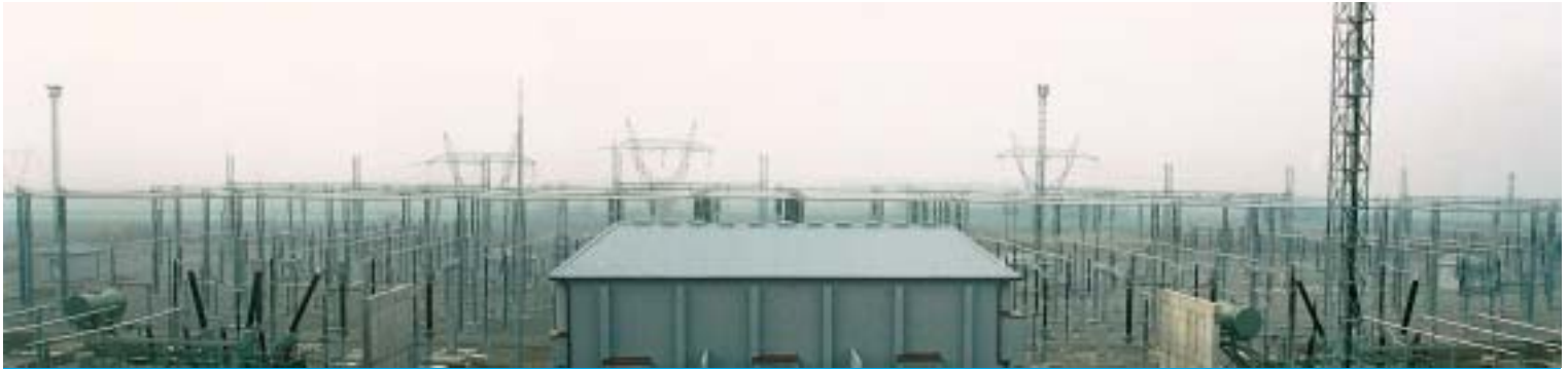
Transformatorska stanica 400/110 kV Ernestinovo obnovljena je i spremna za rad
