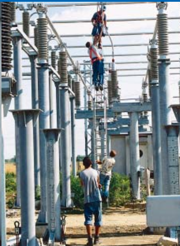
Spajaju se rastavljači na sabirnice 110 kV
