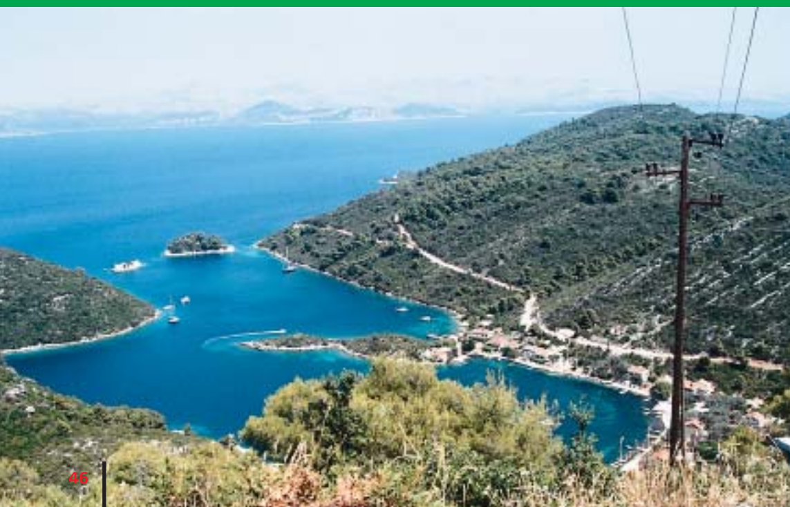
Dalekovod pod Prožurskom lukom
