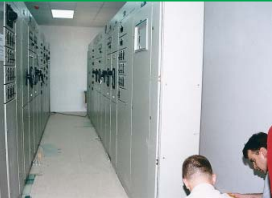
Oprema istosmjernog i izmjeničnog napajanja u upravljačkoj i zgradi pomoćnih pogona
