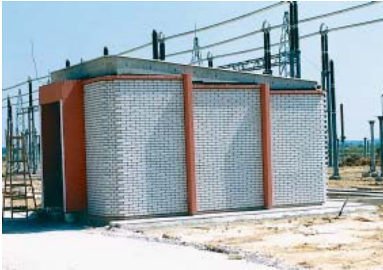
Relejni kućica RK 400 s crvenim obrubom, dogovorenom bojom za 400 kV postrojenje
