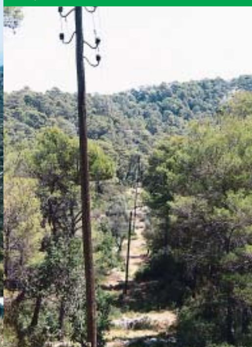
Još je kilometar dalekovoda na drvenjacima koje treba zamijeniti
