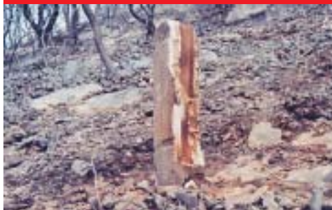
Vatra je otopila i betonske nogare stupova, koji se na dodir pretvaraju u prah
