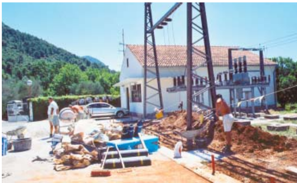
Gradilište u TS Ston, gdje građevinske radove izvodi tvrtka Budim-Brijezi iz Stona
