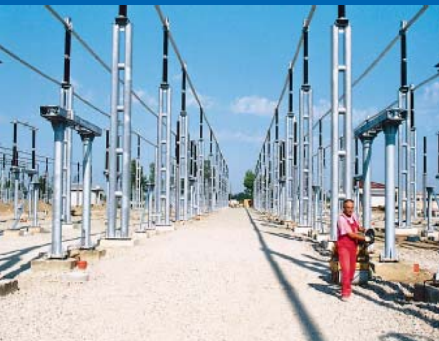
Ispod sabirnica 400 kV završni je sloj tucanika i krupnog pijeska
