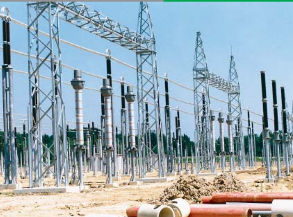
Strujni i naponski mjerni transformatori u RP 400 kV
