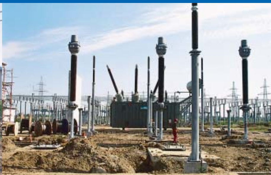
Montirani su strujni transformatori u trafo polju 400 kV
