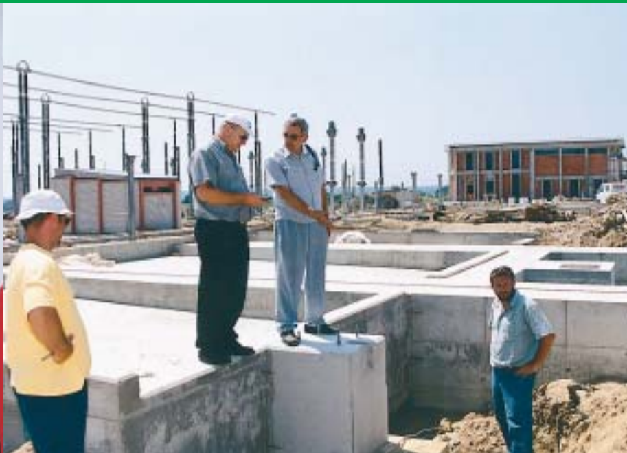
Juraj Brčić s predstavnicima izvođača radova na mjestu gdje će doći transformator T2
