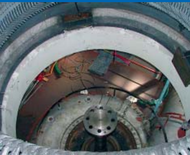
Pogled u strojarnicu CHE Fužine
