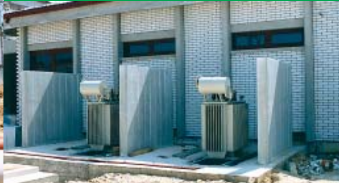
Kućni transformatori 20(10)/0,4 kV, 630 kVA
