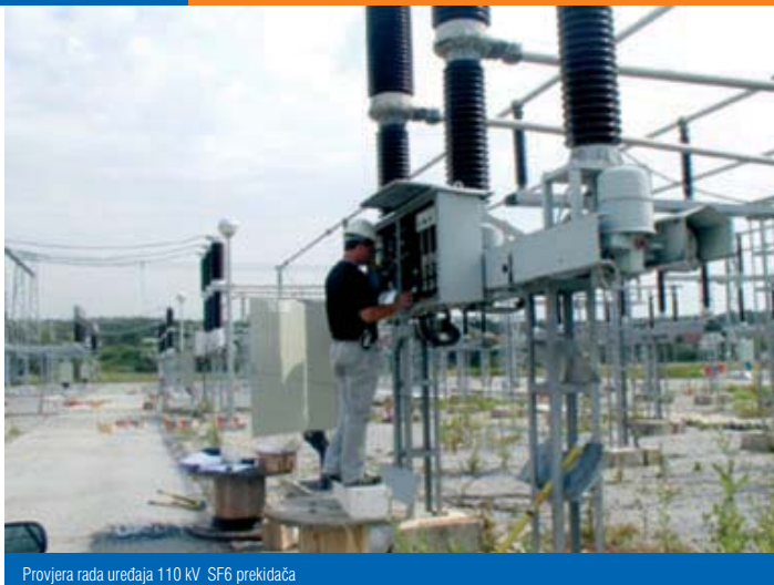
Provjera rada uređaja 110 kV SF6 prekidača
