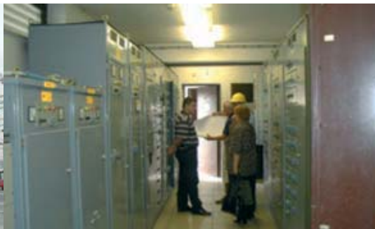
Nada Gracin, glavni inženjer radilišta iz Končar -Keta, Veselin Vujović, glavni projektant izvedbenog projekta iz Končar - Keta i Juraj Brčić, glavni nadzorni inženjer gradnje druge etape TS Dubec iz HEP-a, u obilasku izmjeničnog i dijela istosmjernog razvoda
