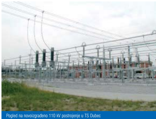
Pogled na novoizgrađeno 110 kV postrojenje u TS Dubec
