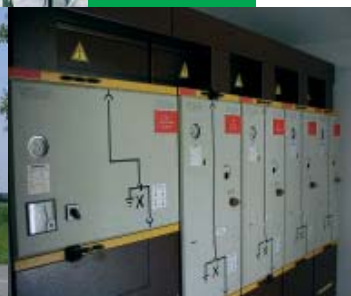
Sokolovac, povećat će sigurnost opskrbe potrošača električnom energijom i omogućiti daljinski nadzor i upravljanje
