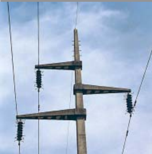
Ove stare porculanske izolatore na 110 kV DV Podsused - Zabok uskoro će prenosaši zamijeniti novim staklenim izolatorima
