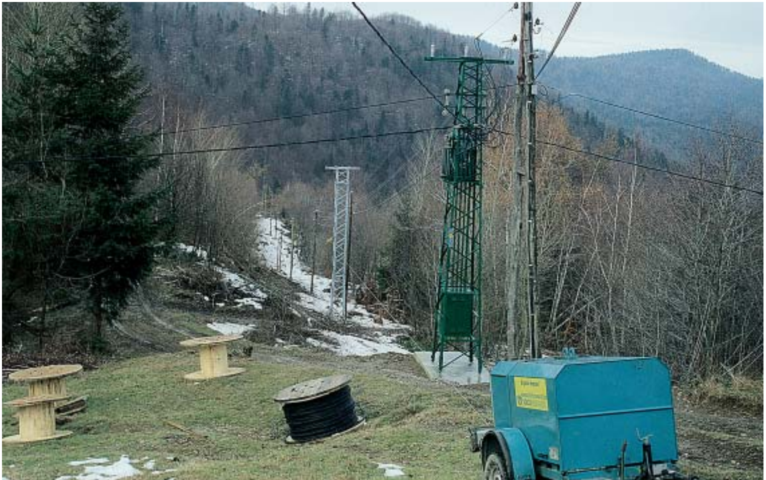
Novoizgrađena trafostanica na jednom kraju 2,2 kilometra dugog dalekovoda
