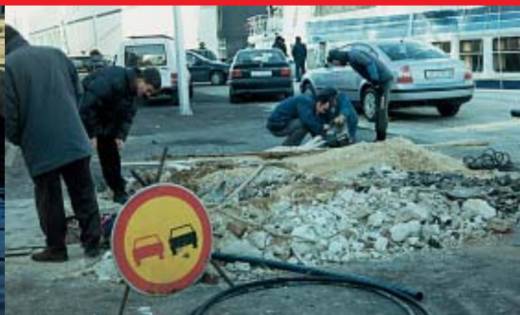
Na ovoj strani obale kabel će ući u TS 10/0,4 kV Grad 5
