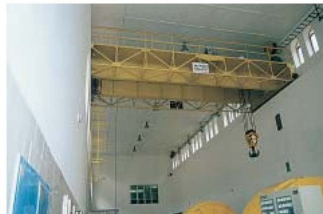
Nedavno popravljena dizalična staza u strojarnici
