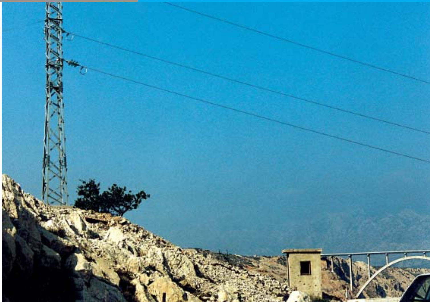
Dalekovod preko Masleničkog ždrila i stup kojeg bi zbog ciklonalnih bura trebalo usidriti
