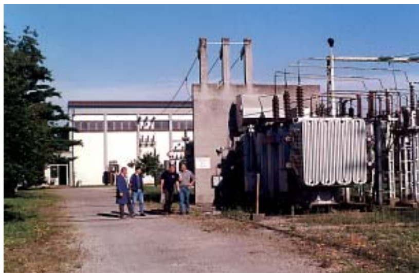
Uskoro u rekonstrukciji: TS 110/35/20(10) kV Požega 2
