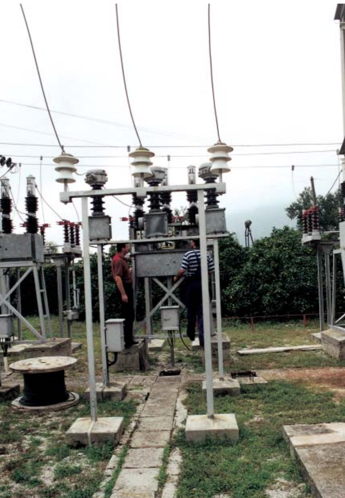
U RP 35 kV ugrađuje se grijanje u prekidače
