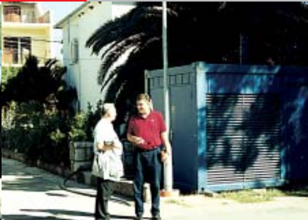
Direktor DP Elektrodalmacija i rukovoditelj Pogona Hvar s osmijehom se opraštaju od posljednjeg agregata u Hrvatskoj
