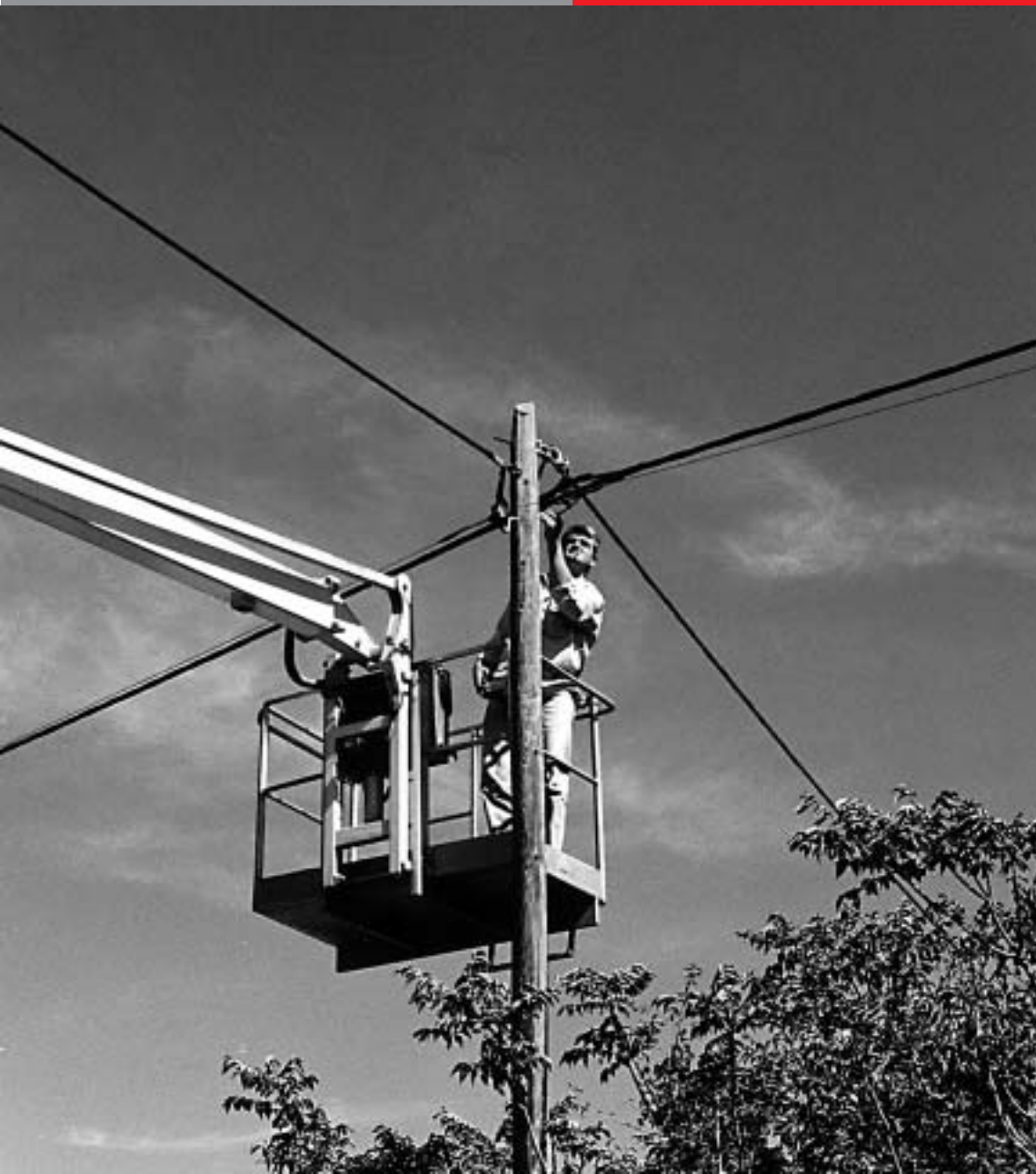
Potrošač uspješno iskopčan na mreži
