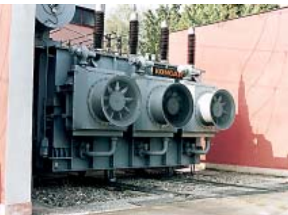
... i novi transformator
