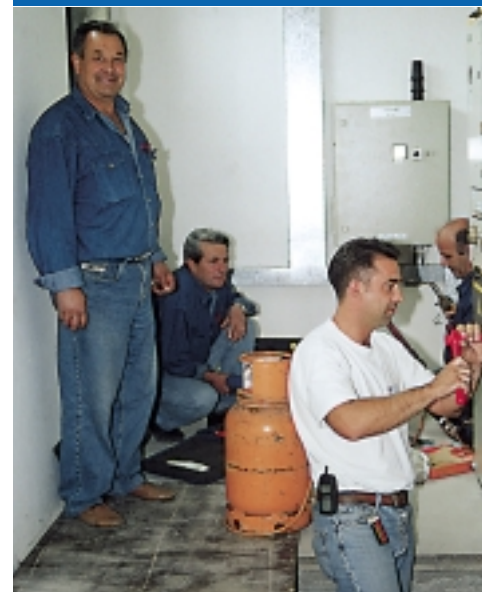
U TS 10/0,4 kV "KONO II" danas rade: poslovođa Marko Rajković i električari Vukašin Miletić, Ivo Puh i Danijel Vuković
