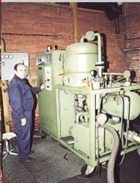
Ispred separatora Antun Jeger nadzire obradu trafo-ulja
