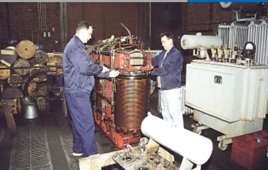
T. Maretić i I. Perlinger na reviziji transformatora
