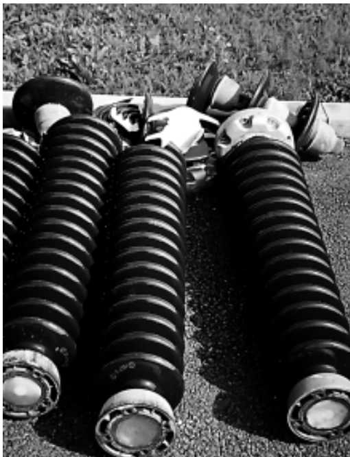
Oštećeni izolatori 110 kV u TS Tumbri, izbliza...
