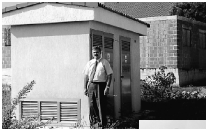
Tomislav Dražić, rukovoditelj Odjela za razvoj i investicije DP Elektra Zadar uz virku trafostanicu Pedinka izgrađenu 1998. godine
