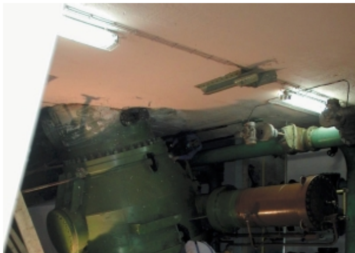
Sanirana su ležišta kuglastih zatvarača na turbinama agregata A, B i C
