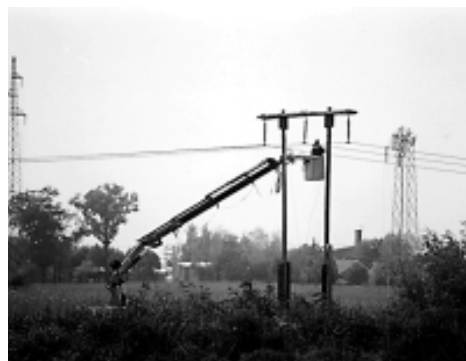
Popravlja se i jedan drvenjak 110 kV, snimljen s udaljenosti, jer se do njega nije moglo doći bliže bez primjereno jake mehanizacije
