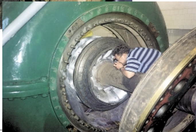
... defektaža rotora agregata 2
